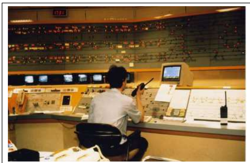
Poste Central de Contrôle au puits de Sangatte Coordination des trafics et de la sécurité
